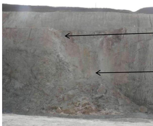
а - трещины в откосе уступа;
