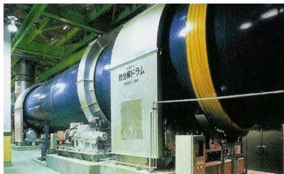
Рис.5. Реактор пиролиза на заводе термической переработки ТКО Toyohashi, Япония.
