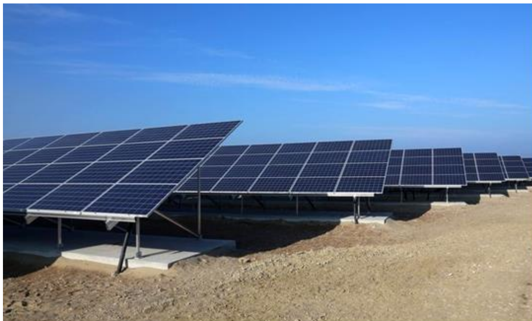
Рис. 4. Фотоэлектрическая станция пиковой электрической мощностью 1000 кВт в г. Каспийске, Республика Дагестан, 2013 г.
