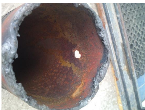
Рис. 3. Коррозия газопровода (г. Киров, ул. Некрасова)
