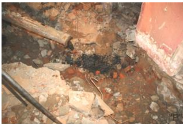
Рис. 3. Разрушенный трубопровод спецканализации.
