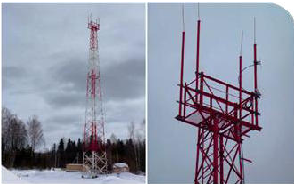
Рис. 2. Опора связи широкополосного радиодоступа (технология WiMAX) на Мишкинском нефтяном месторождении ПАО «Удмуртнефть» им. В.И.Кудинова
