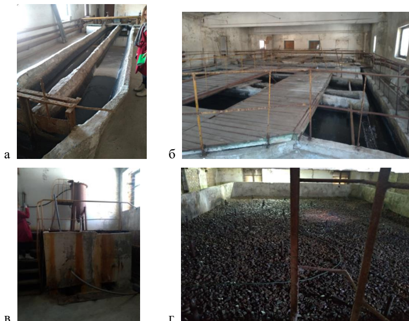
Рисунок 2 - Техническое состояние функционирующих очистных сооружений канализации: а – песколовки; б - двухярусные отстойники; в – хлораторная; г - биофильтр
