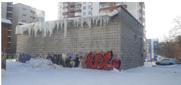
Рисунок 1 – Наледь на здании теплового пункта. Фото А.С. Искра
