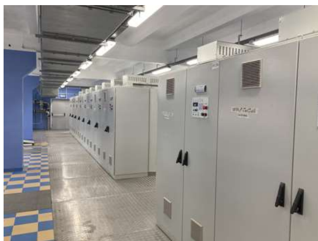
Рис 12: Шкафы с источниками питания в к.205.
