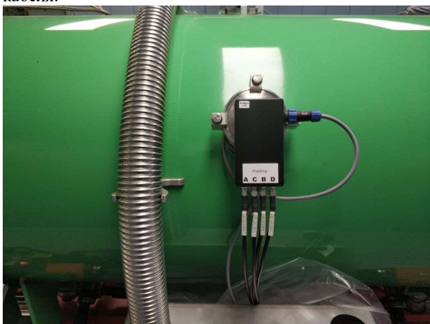
Рисунок 2: Предусилитель, установленный на корпусе Бустера.
