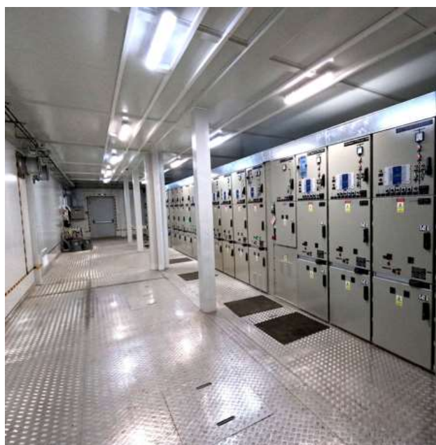
Рис 11: Подстанция ПС 15. Внутри расположены высоковольтные ячейки типа DP-12P.
