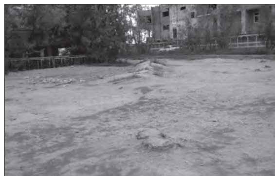
Рис. 5. Деформация дорожного полотна в результате морозного пучения грунта в районе ул. Ярославского (фото И.В. Дорофеева).
