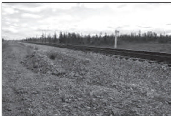
Рис. 3. Деформация земляного полотна. (174 км).
