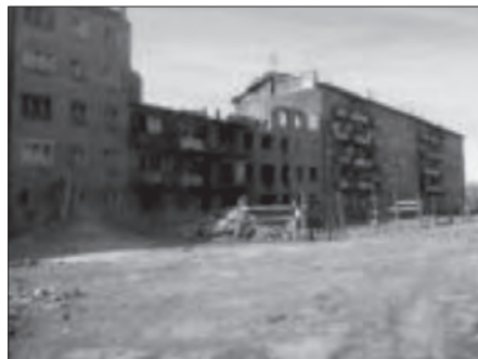
Рис. 1. Аварийная разборка части здания на ул. Ползунова в г. Чите.
