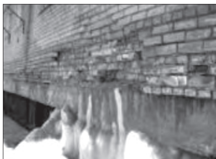
Рис. 2. Разрушение кирпичной кладки техногенной наледью.
