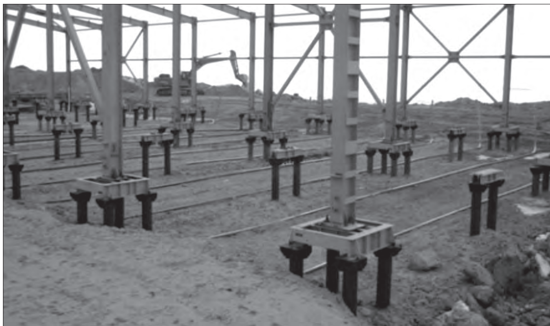
Рис. 4. Засыпка грунтом смонтированных ДОУ-1 модификации 03 при строительстве здания с полами по грунту на Бованенковском НГКМ.
