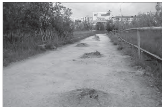
Рис. 4. Деформация тротуара в результате морозного пучения грунта в районе улицы Ярославского (фото И.В. Дорофеева).
