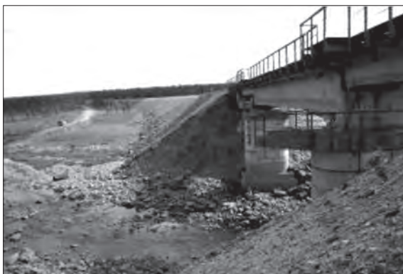
Рис. 2. Сплыв откоса насыпи в результате размыва ее основания в паводок у мостового перехода. Верховье ручья Васильевский (171 км).
