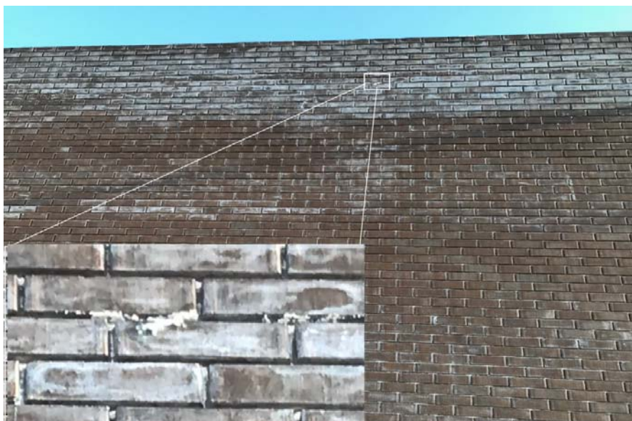
Рис. 2. Образование высолов между рядами кирпичной кладки
