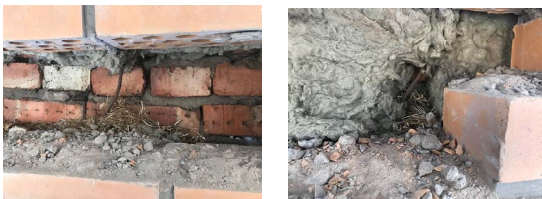
Рис. 2. Дефекты ограждающей конструкции
