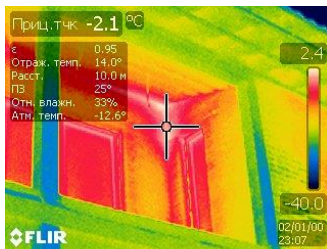
Рисунок. Теплопотери на узле примыкания несущих конструкций
