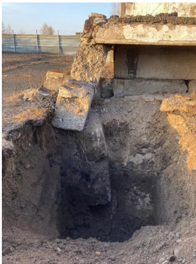
Рисунок 5. Аварийное состояние фундамента
