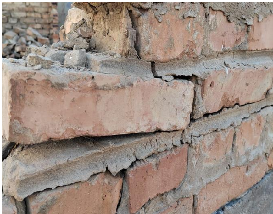
Рисунок 2 Адгезия кирпича и кладочного раствора
