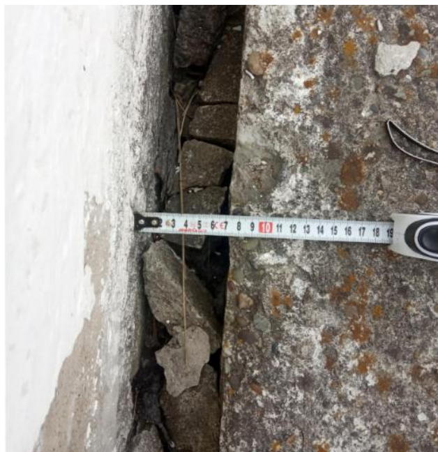
Рисунок 4. Зазор между панелью и отмосткой
