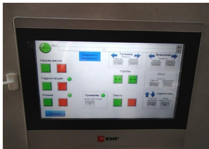
Рисунок. Щит управления
