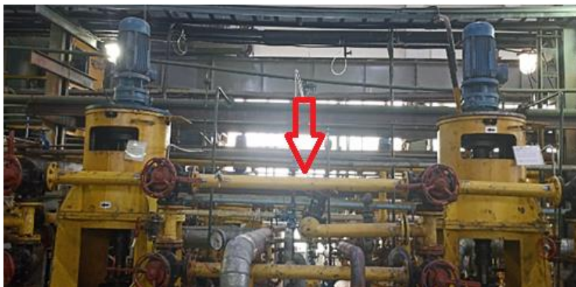
Рисунок 1. Трубопровод между двумя полимеризаторами
