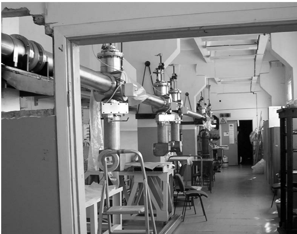
Рис. 12: Канал в зале для пользователей. Видны спуски к экспериментальным станциям.
