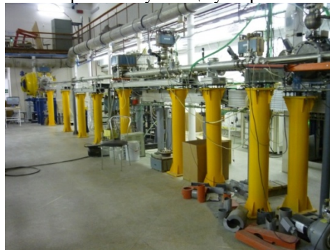
Рис. 5.2.5. Экспериментальный зал и новый канал вывода СИ.
