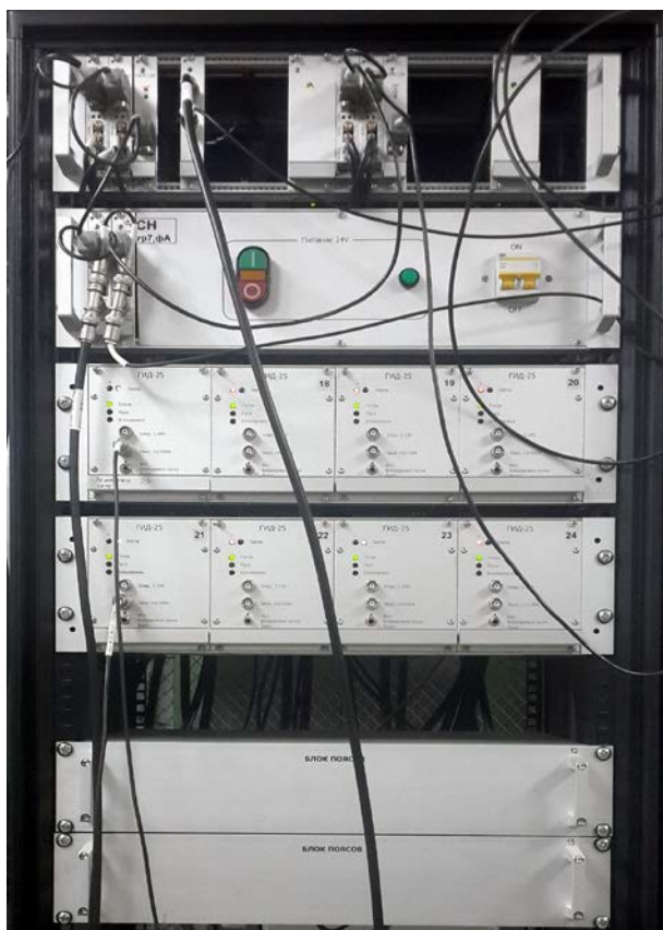
Рисунок 2. Стойка (крейт) с источниками ГИД-25.
