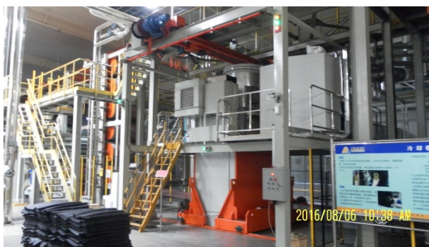
Рисунок 3. Ускорительная установка в местной защите на шинном заводе “Zheng Shi Tai Lai”, Китай (г. Чинчжоу, пров. Шаньдун).
