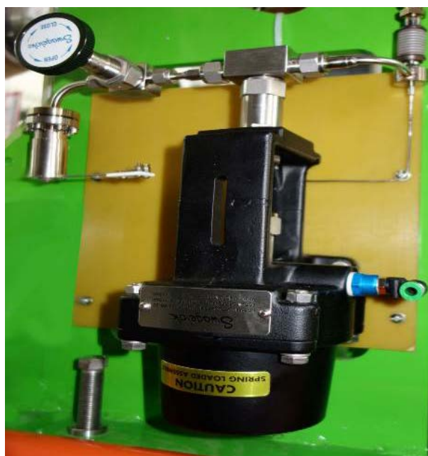
Рисунок 6.3 Вид части цезиевой системы со стороны атмосферы (без теплозащиты).
