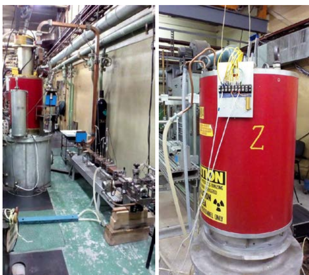
Рисунок 21. Стенд для испытаний отдельных узлов и элементов будущих систем питания (слева). Подготовка соленоида клистрона на измерительном стенде для измерения профиля магнитного поля (справа).
