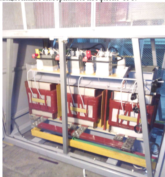
Рисунок 10. Внешний вид трансформатора заводского исполнения.
