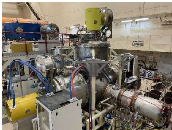
Рисунок 1. Установка КОТ в защищённом зале.
