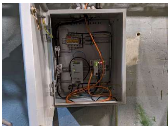
Рисунок 24. Расположение ПЛК в шкафу на стене рядом с теплообменником ТО-4.
